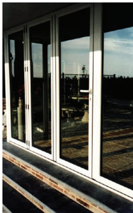
Afb. 3 Vensterdeur met een verbeterde waterdichtheid onderaan, die echter niet toegankelijk is tengevolge van het vaste onderprofiel en de drie treden voor de deur.
